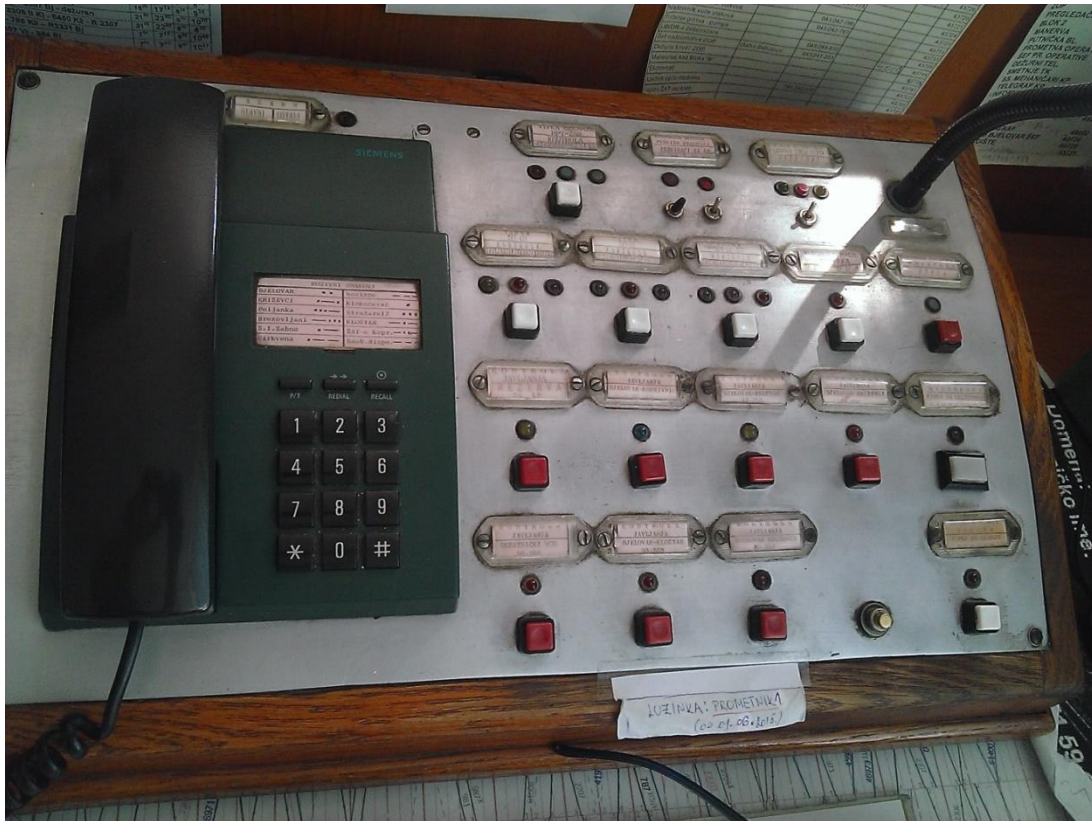
Slika 8. Telekomunikacijski pult u prometnom uredu Bjelovar
