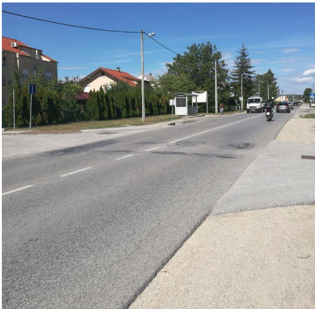
Slika 5. Stanje kolnika na početku županijske ceste ŽC 3063
