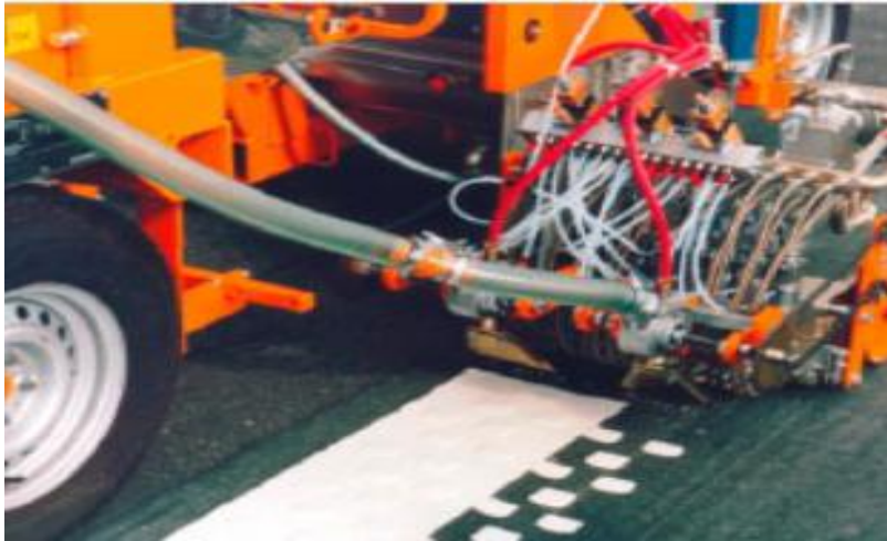
Slika 39. Oznaka na kolniku izrađena termoplastikom
